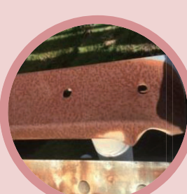
がたつき・錆(高欄)
