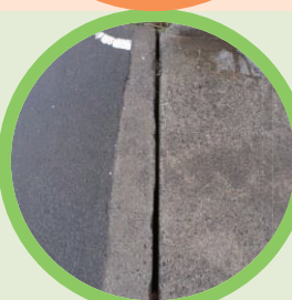
目地板の抜け(伸縮装置)
