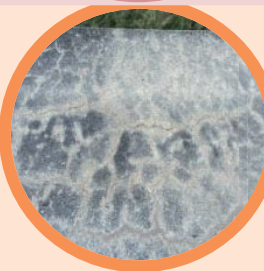
ひび割れ(地覆)
