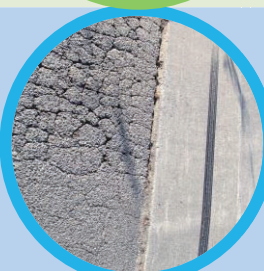
橋前後のひび割れ(舗装)
