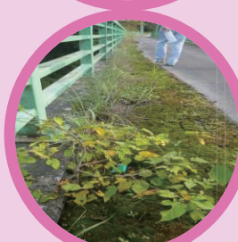
土泥コケ草(地覆舗装間)隙間がない(伸縮装置)歩道部の凸凹(舗装)
