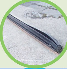
段差(伸縮装置)
