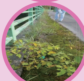
土泥コケ草(地覆舗装間)隙間がない(伸縮装置)歩道部の凸凹(舗装)
