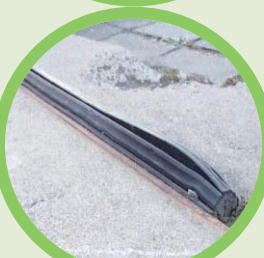
段差(伸縮装置)
