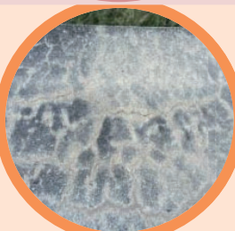
ひび割れ(地覆)
