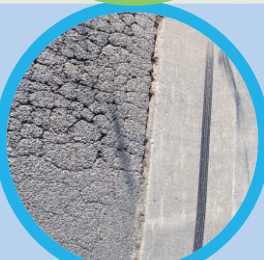
橋前後のひび割れ(舗装)
