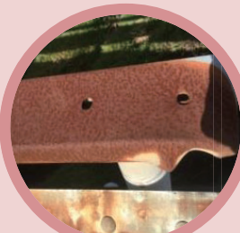
がたつき・錆(高欄)
