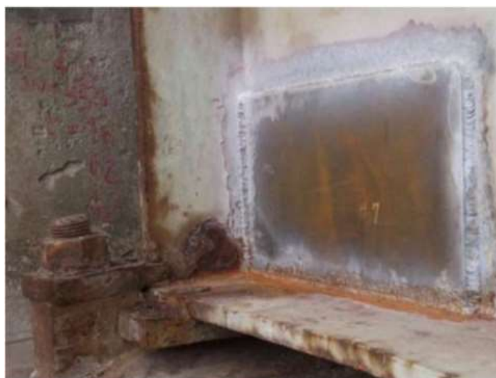
図-3 桁端部の劣化
