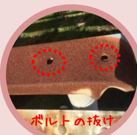
がたつき・錆(高欄)
