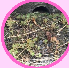
土泥コケ草(排水桝)土泥コケ草(地覆舗装間)隙間がない(伸縮装置)歩道部の凸凹(舗装)
