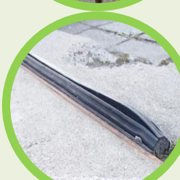
段差(伸縮装置)
