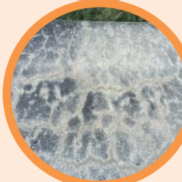
ひび割れ(地覆)
