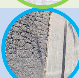
橋前後のひび割れ(舗装)
